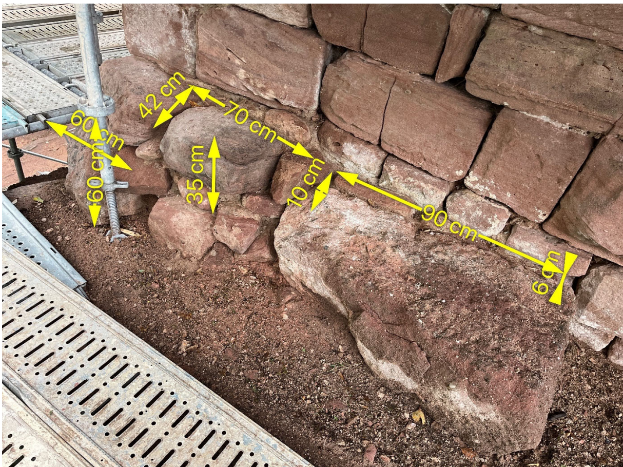
Angle du mur O/N – reprise (en dépose/repose) de la maçonnerie devant le pied de mur
