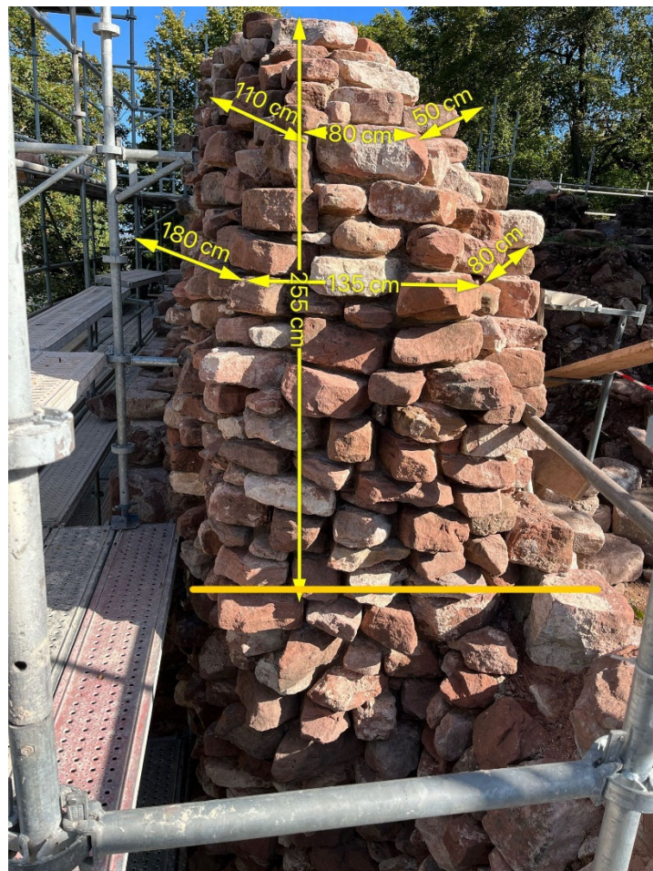
Mur N3 – Façon d’arrachement contre le blocage suspendu conservé en raccord avec la colonne ci-dessus
