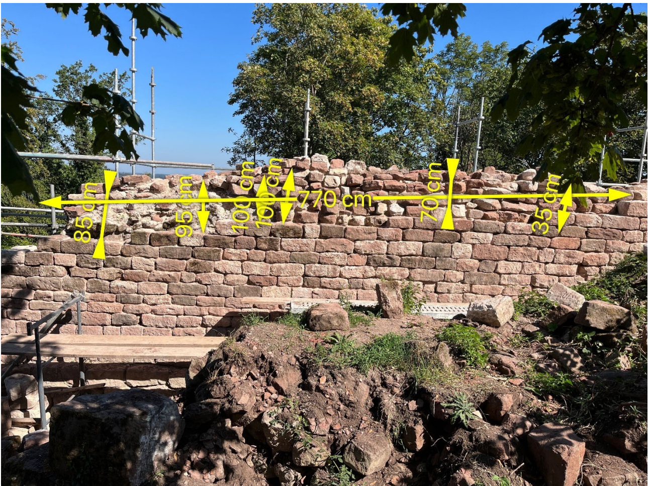
Mur N – Arrachement côté intérieur en cours de finition (parement réalisé par l'association)
