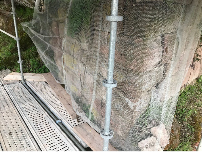
Partie basse sous l'effondrement et au-dessus du rocher à droite
